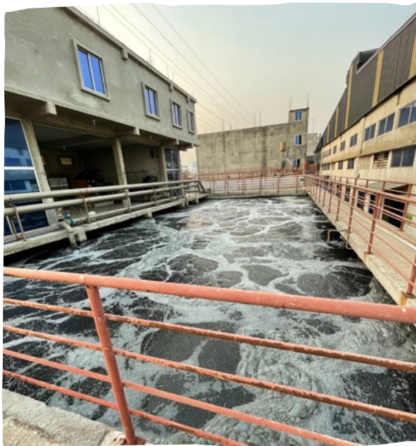
Foto de um sistema de tratamento de água de um dos nossos fornecedores que participa no projeto Better Mill.
